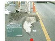
大きめのポットホール
