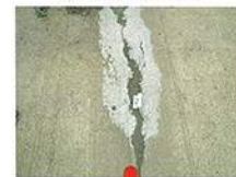
大きめのクラック
